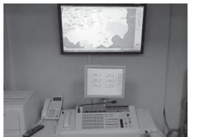
防災行政無線 親局 (市役所第2別館内)
