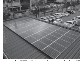
▲太陽光パネル(市役所第2別館屋上)
