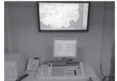
防災行政無線 親局 (市役所第2別館内)
