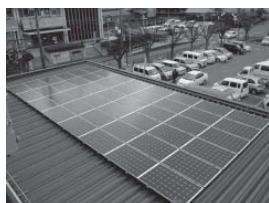
▲太陽光パネル(市役所第2別館屋上)
