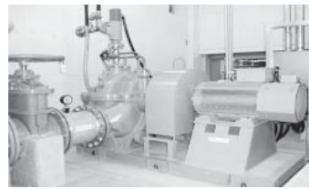
小水力発電設備
