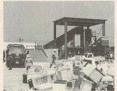
6月12日(金)、粗大・不燃物 ゴミ処分場に8900万円 をかけて、破砕機が完成、 稼動をはじめました。
