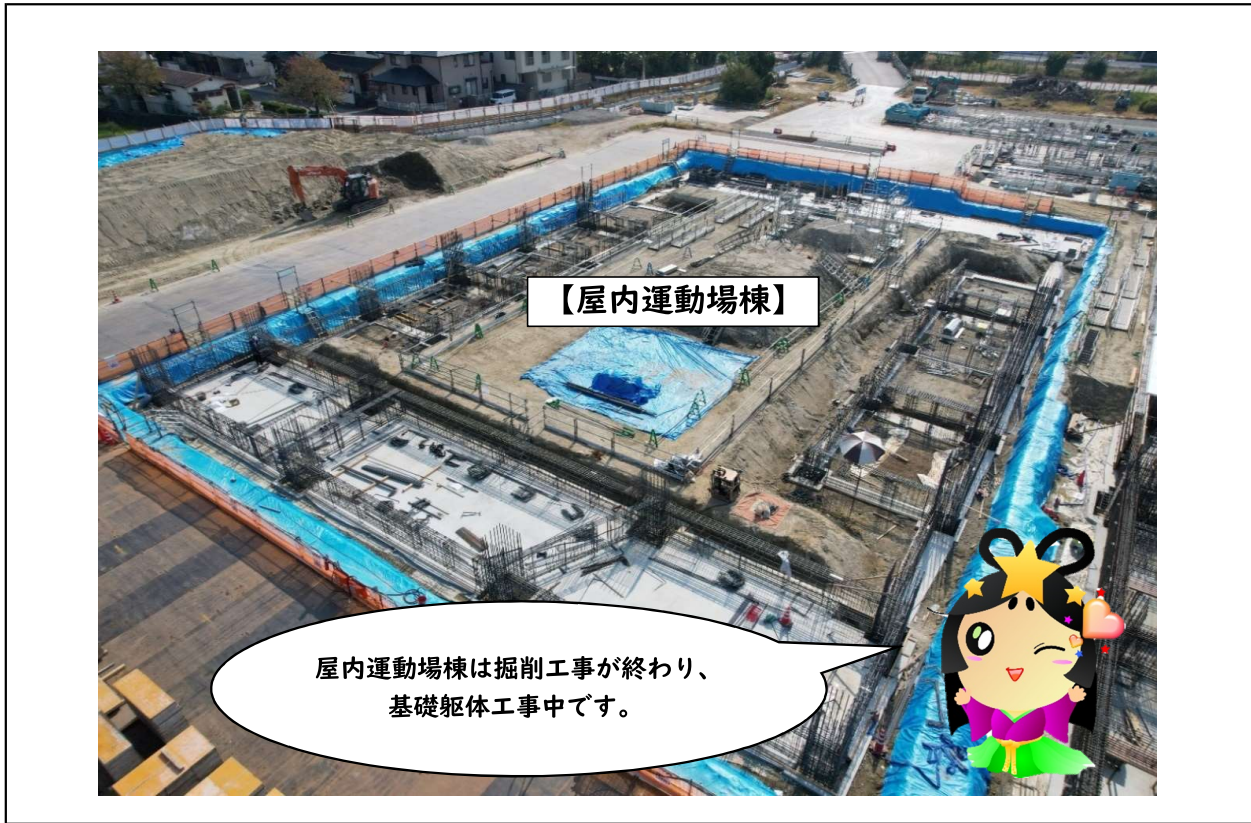
説明 【屋内運動場棟】基礎躯体工事状況 撮影箇所 北側より撮影
