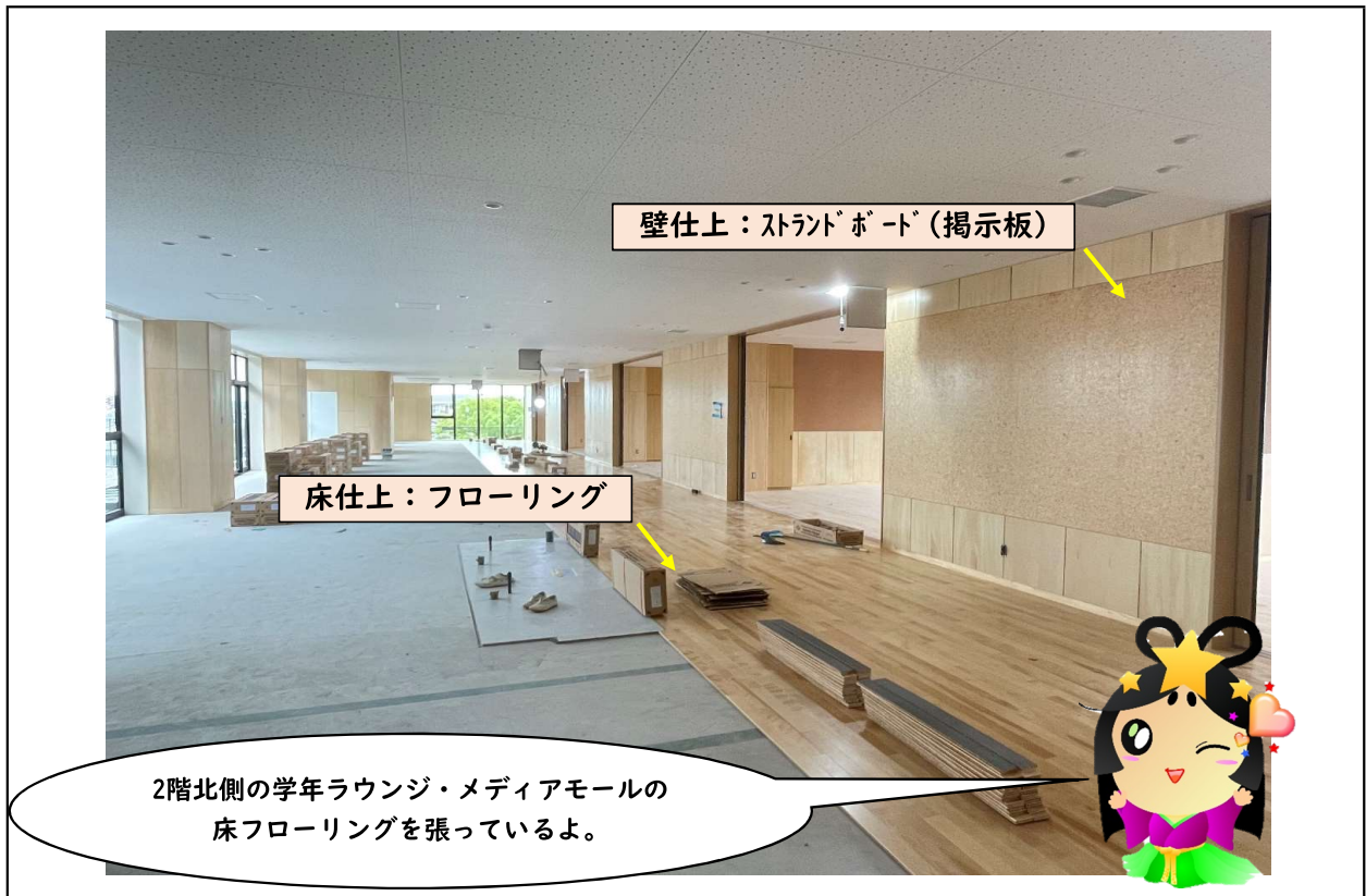
説明 【校舎棟】2階 内装仕上げ工事状況 撮影箇所 校舎棟2階 北側より撮影
