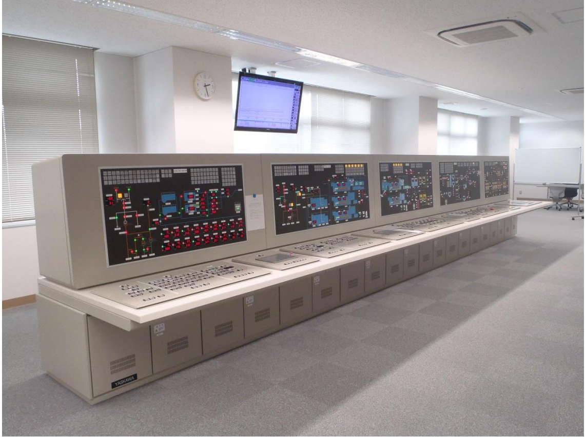
中央操作監視室
