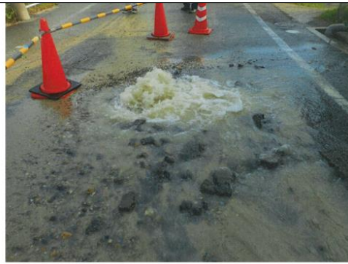
経年劣化による漏水
